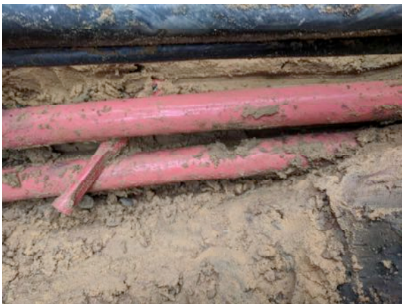
Bild 1: Zerstörtes 20 kV-Kabel mit Loch im Mantel
